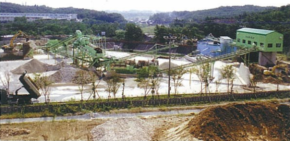
建設汚泥のリサイクルプラント
