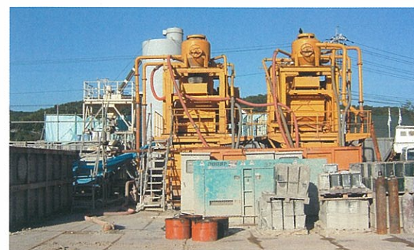
浚渫汚泥のリサイクルプラント
