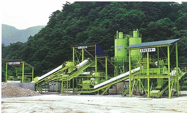
脱水ケーキのリサイクルプラント
